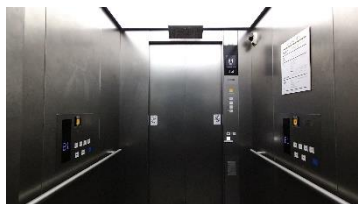
1階事務所横エレベーター
