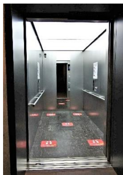
大ホール内エレベーター
